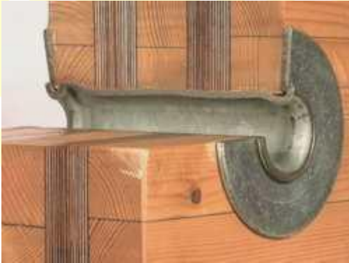
Open gezaagde verbinding na buisexpansie
